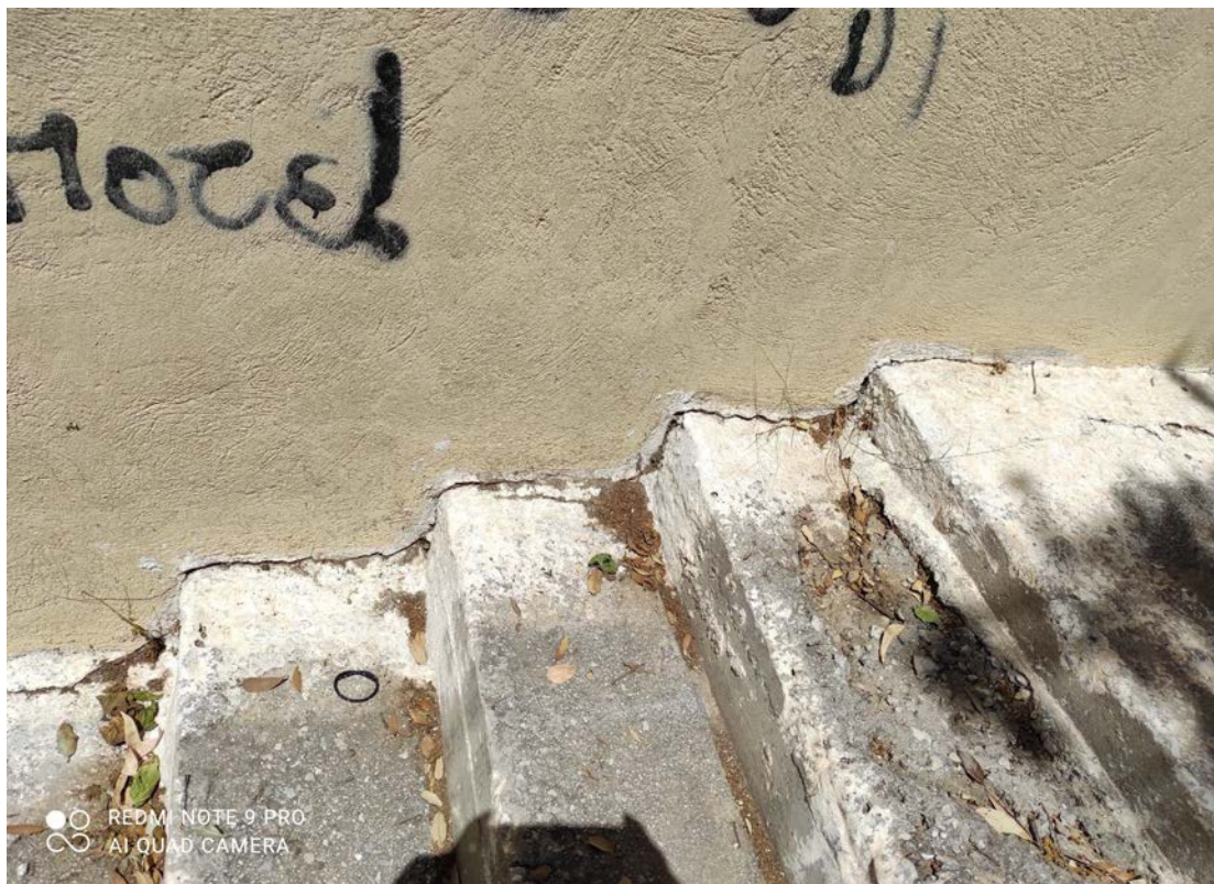
Φωτό 6: Καθίζηση αναβαθμών στο Νότιο τμήμα της Ανατολικής Όψης του κτιρίου
